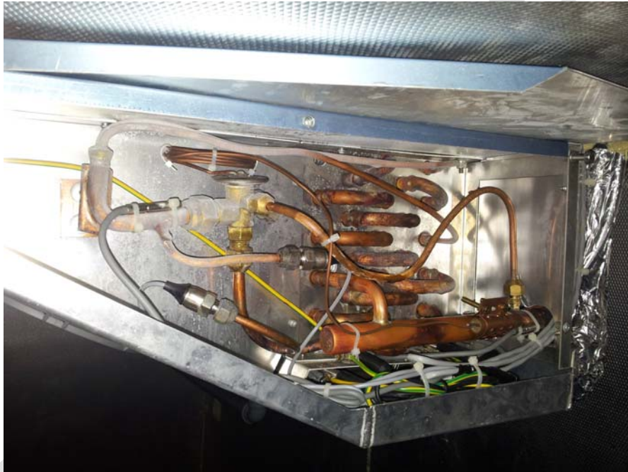
Figura 2.2 Răcitor de aer
